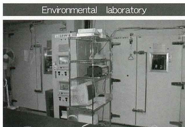
写真－1 空気環境実験室
